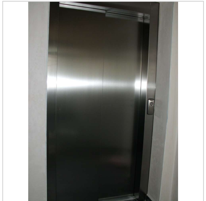
Aufzug bis in die Tiefgarage
